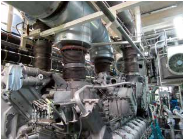
Maschinenraum mit neuer Hauptmaschine
