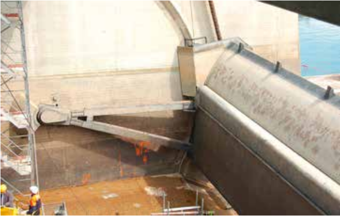
Zugsegmentverschluss Bad Abbach zur Trockenlegung
